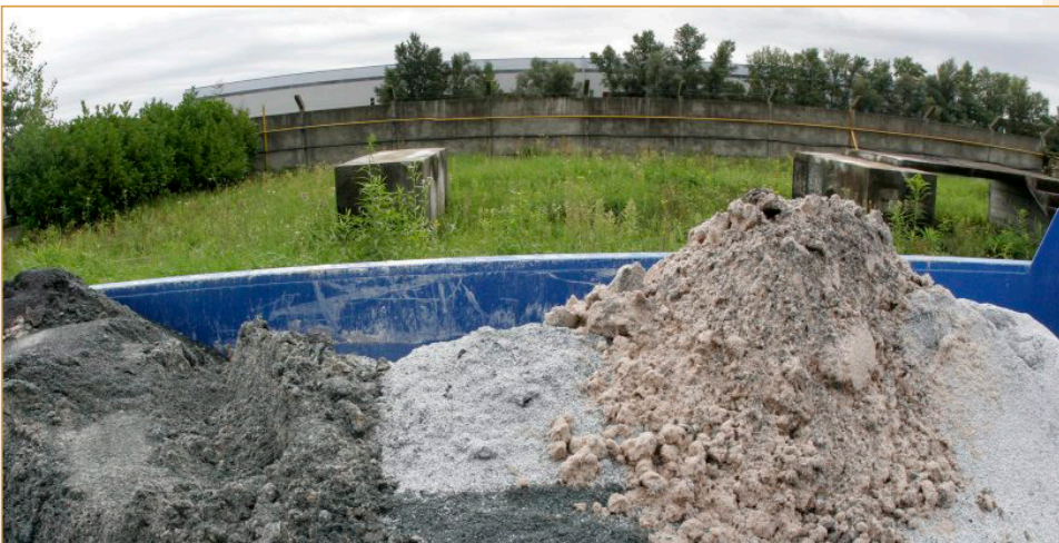
Déchets minéraux (paillettes d'ardoise et déchets de démolition) recyclés pour réutilisation dans les remblais de routes
